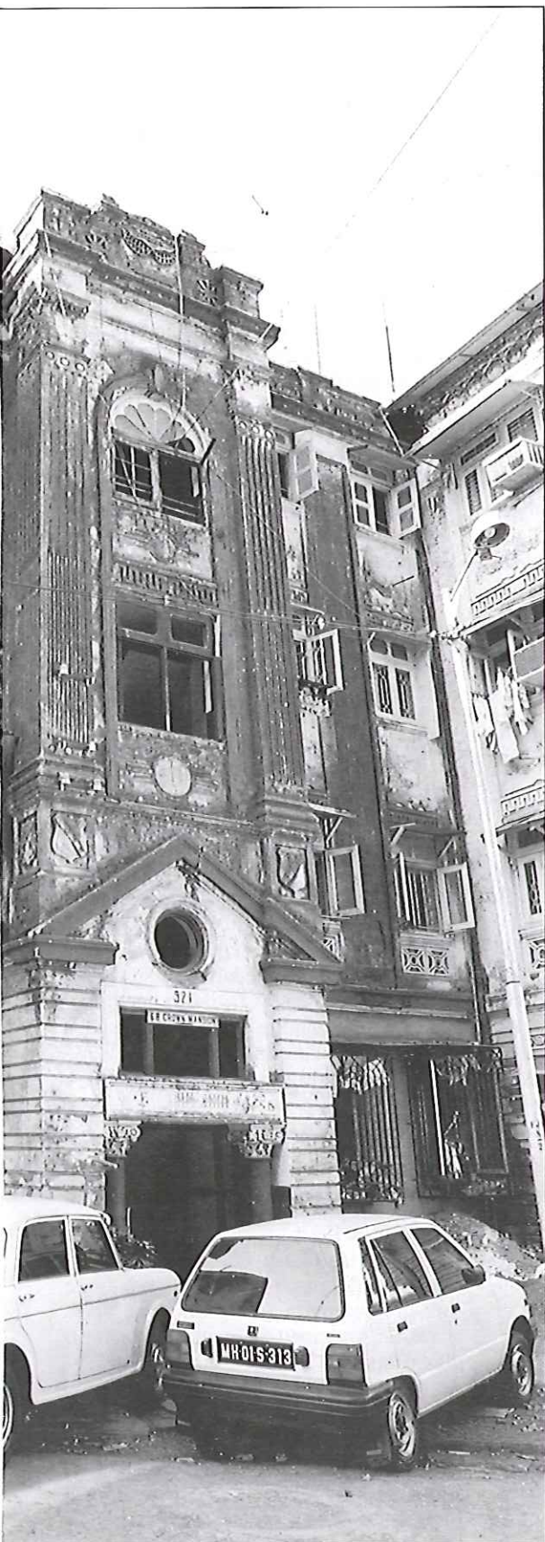
kommer mellan 20 och 50 människor under monsunstiden när regnet underminerar dåligt underhållna hus och får dem att kollapsa. FOTO: PAR JANSSON
